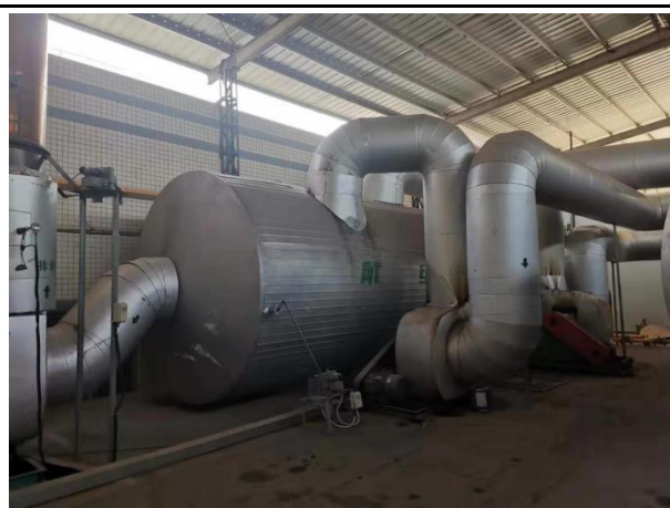
废气处理设施
