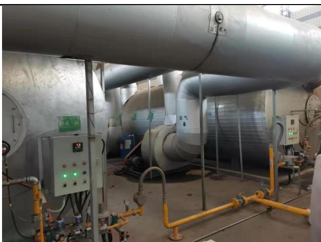
废气处理设施
